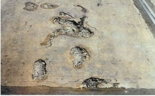
A: Concrete spalling
